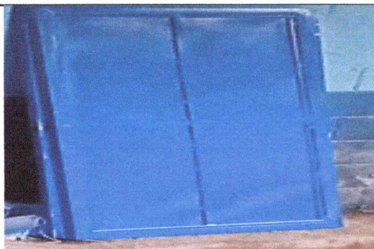
Foto 9: Estado actual de las puertas de áreas de baños.
